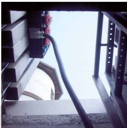
Zámok Junkers, Gotzis: Podzemný rozvádzač Piazza 1000 pre zásobovanie prúdom, a aj ako vstupná šachta.
