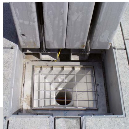
Nové námestie, Klagenfurt: šachta odpadovej vody s mrežou. Šachta môže byť uzatvorená aj počas používania hadice odpadovej vody.
