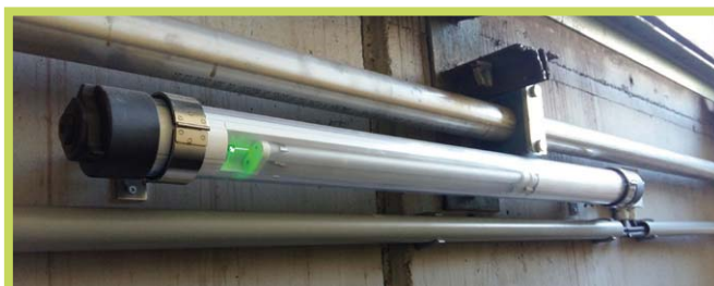
StreamLED 70 Núdzové osvetlenie– Núdzové osvetlenie v kolektore
