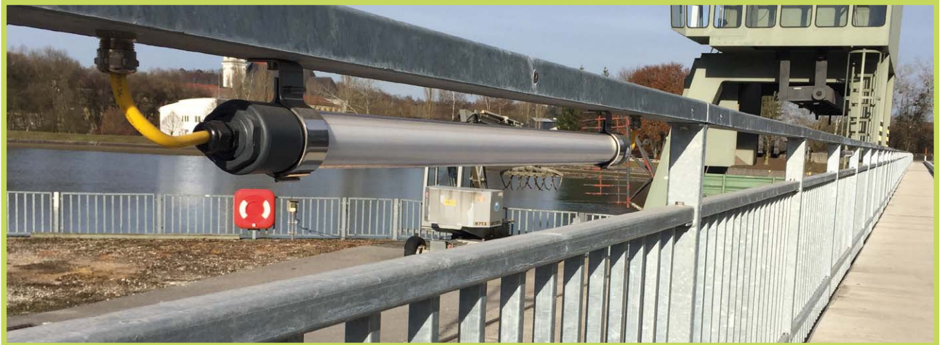
StreamLED Power – Osvetlenie mosta v zábradlí
