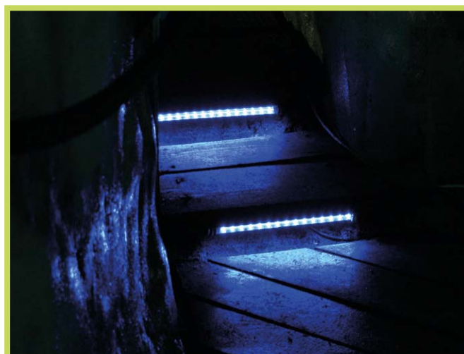
AmbitLED – Osvetlenie schodišťa v ľadovej jaskyni
